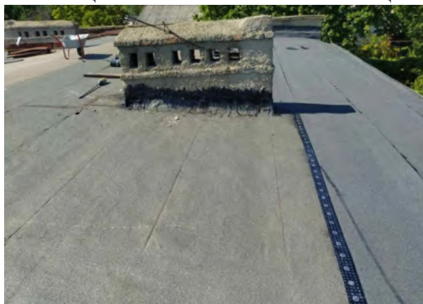
Рис. 5. Состояние кровли жилого дома по ул. Пирогова 8б после замены гидроизоляционного ковра
