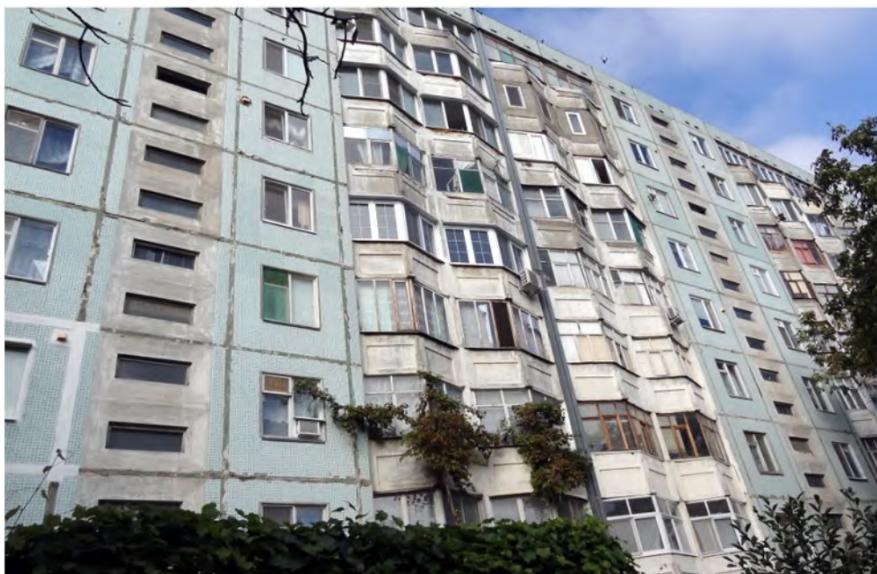
Рис. 2. Состояние фасада и герметичность межпанельных швов жилого дома по ул. Ленинградской 42, серии Варницкая.
